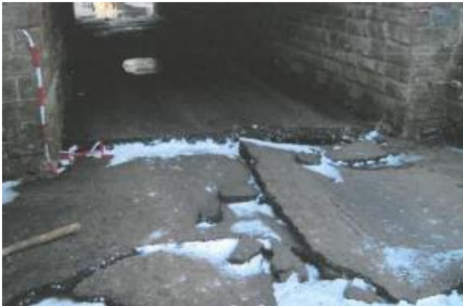
Flutschäden im Bereich Heuloch (Foto: Edgar Steffes)
